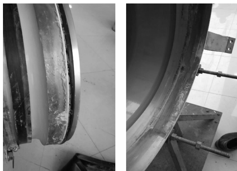
图3 伸缩滑动组件腐蚀位置和外观
