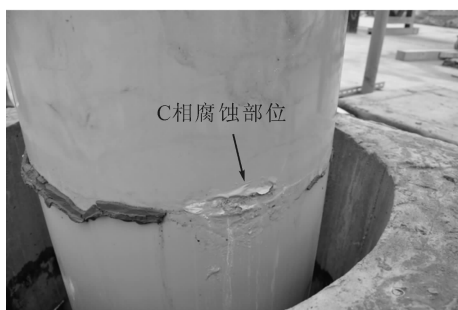
图1 C相穿墙母线腐蚀位置和外观
